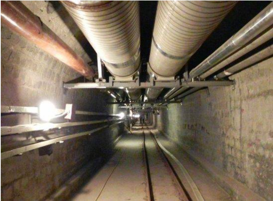
A kellemes, meleg hőmérsékletű alagút a Tabán városrészben lévő Rác-fürdőig járható. A fejünk feletti távfűtővezeték Kelenföldről szállítja a melegvizet a Várnegyedbe.
