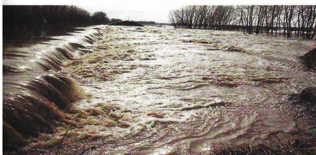
A tarpai felső töltésszakadás – 2001. március
